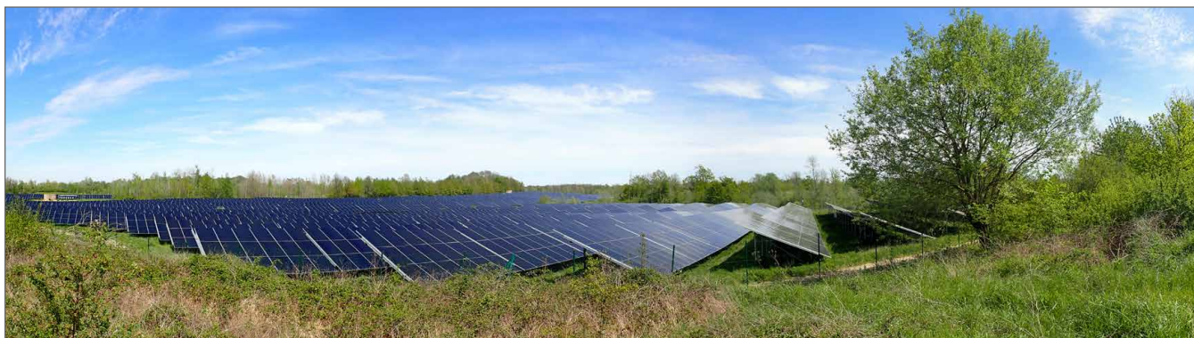
Photo 115 : Étendue de la centrale photovoltaïque de Pargny-sur-Saulx
