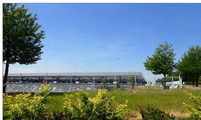
Photo 47 : Des ombrières sont installées sur le parking de l'aéroport de Vatry
