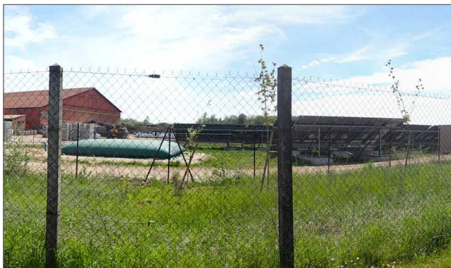
Photo 113 : Perception depuis l'ancien quartier ouvrier de la tuilerie, au Sud-Est de Pargny-sur-Saulx, face au parc photovoltaïque au sol et ses équipements annexes
