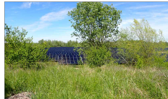
Photo 114 : Étendue de la centrale photovoltaïque de Pargny-sur-Saulx masquée en partie par la végétation qui borde le GR 14B
